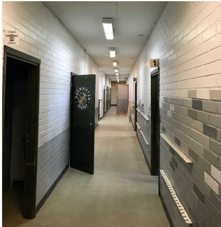
Pukuhuoneiden yhteydessä olevan käytävän valaistus.
