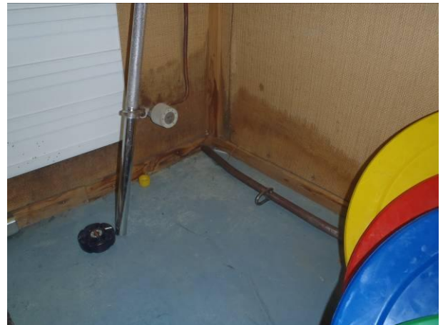
Kuva R16. Väestönsuojatiloissa havaittiin vuotojälkiä seinässä.
