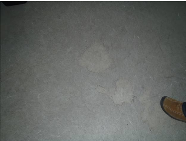
Kuva R13. Luistinterämatto on paikoin hyvin kulunut.
