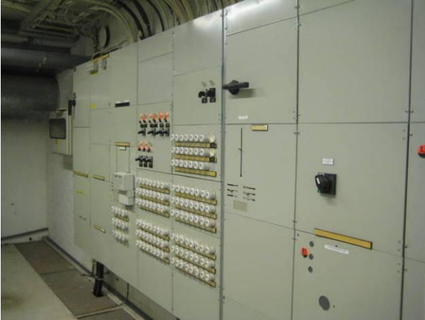
Kuva S7. Näkymä pääkeskuksesta
