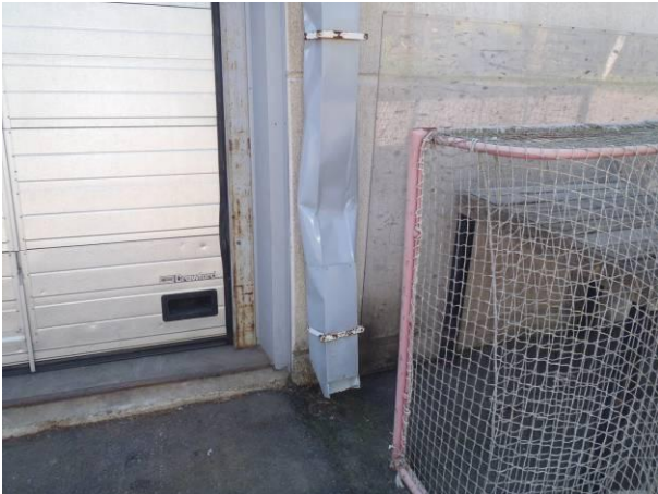
Kuva R6. Kattosadevesien poisto on toteutettu syöksyputkilla. Syöksyputket ovat paikoin kolhiintuneita ja aiheuttavat kosteusrasitusta julkisivurakenteille
