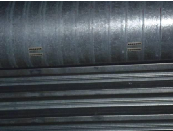
Kuva L2. Ilmanvaihdon pääte-elimenä on halliosalla suutinkanavaa.
