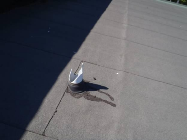
Kuva L6. Tuuletusviemärin yläpää on poikki vesikatolla.
