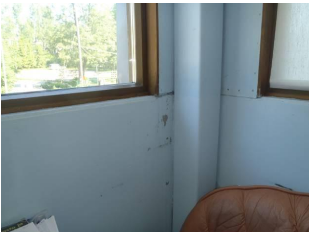
Kuva R7. Toimiston seinustalla vesivuotojälki.
