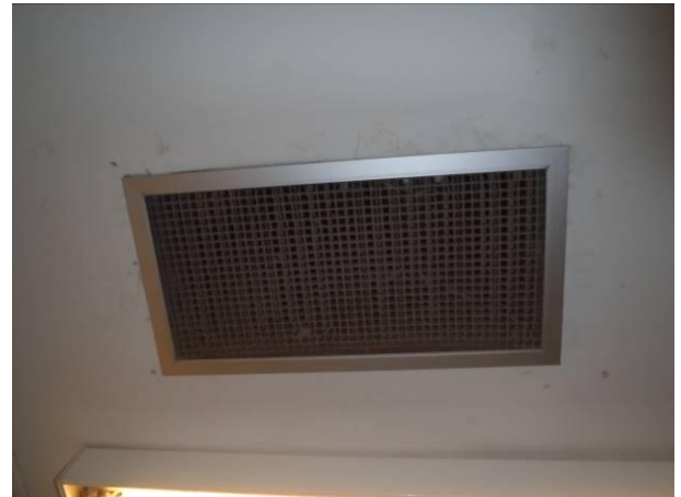
Kuva L5. Likainen poistoilman pääte-elin käytävällä.
