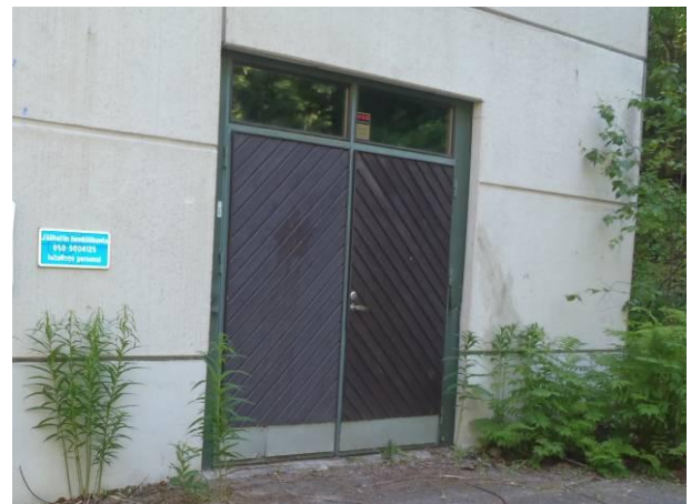
Kuva R10. Oven pellityksissä havaittiin vaurioita.
