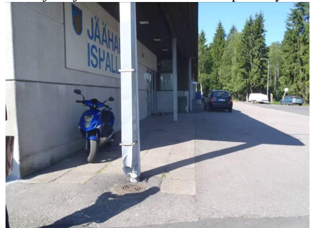
R4. Sisäänkäynnin kohdalla betonilaattojen kallistukset ovat arviolta riittämättömät.
