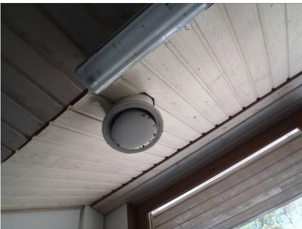
Kuva L3. Likainen poistoilman pääte-elin pukuhuoneessa.
