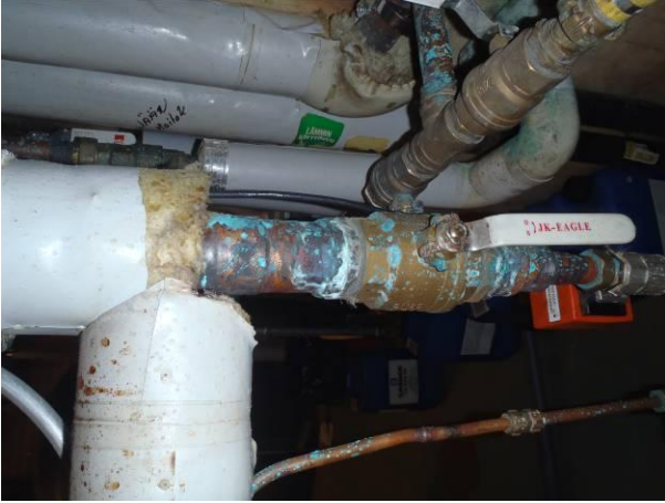
Kuva L1. Käyttövesiverkoston alkuperäinen linjasulkuventtiili on käsikahvallinen palloventtiili.
