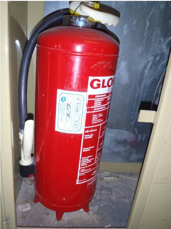
Kuva L7. Käytävällä oleva käsisammutin on tarkastettu asianmukaisesti.
