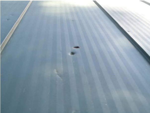
Kuva R12. Peltikatteessa havaittiin reikiä.
