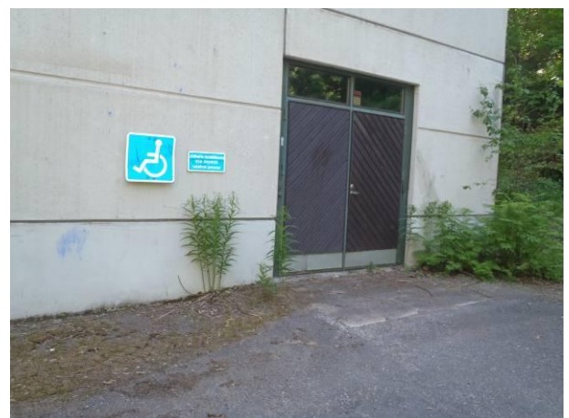
R5. Rakennuksen vierustalla on kasvillisuutta, josta aiheutuu tarpeetonta kosteusrasitusta julkisivuille.
