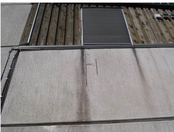
Kuva R2. Julkisivun terästen aiheuttamia korroosiovaurioita.
