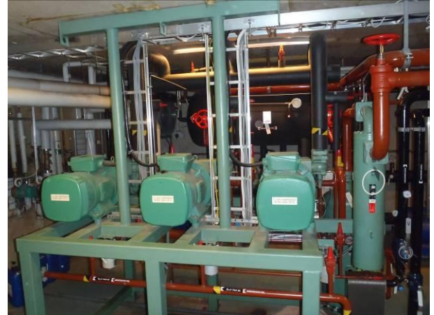
Kuva L8. Jäähdytyskoneikko on uusittu vuonna 2004.
