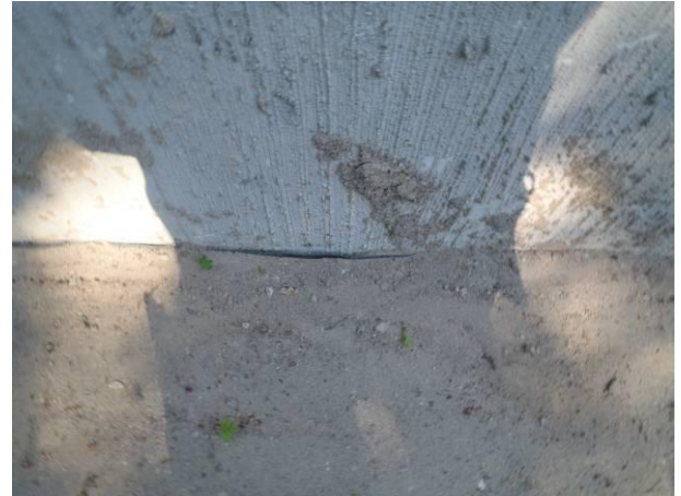
Kuva R3. Rakennuksen vierustan kosteusongelma on korjattu ja seinustalle on asennettu patolevyt.
