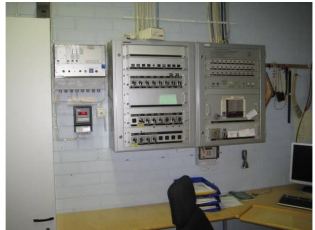
Kuva S4. Alkuperäisiä ohjauskeskuksia 1. kerroksen valvomossa.
