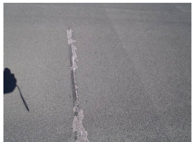
Kuva R11. Kermikate on paikoin kulunut puhki.
