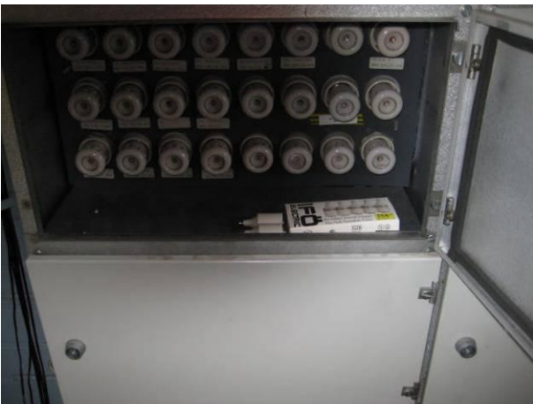
Kuva S8. RK 1.1 keskuksen sisällä säilytetään sulakkeita.
